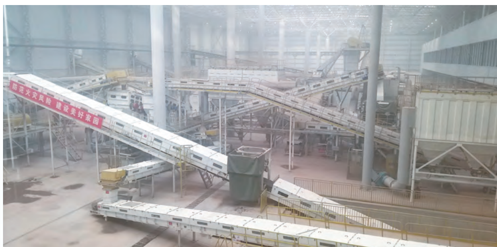
項目廠區封閉式管理，防止廢氣外漏排放
