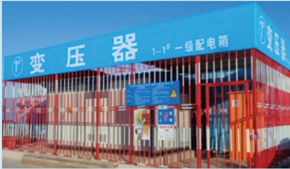
箱式變壓器防護
