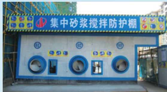
設備編號、驗收標認
