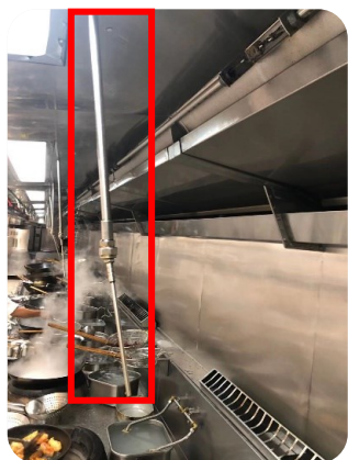
圖 3b – 安裝於爐頭上的傳感器監測排風需求
