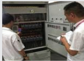
配電櫃專項檢查
